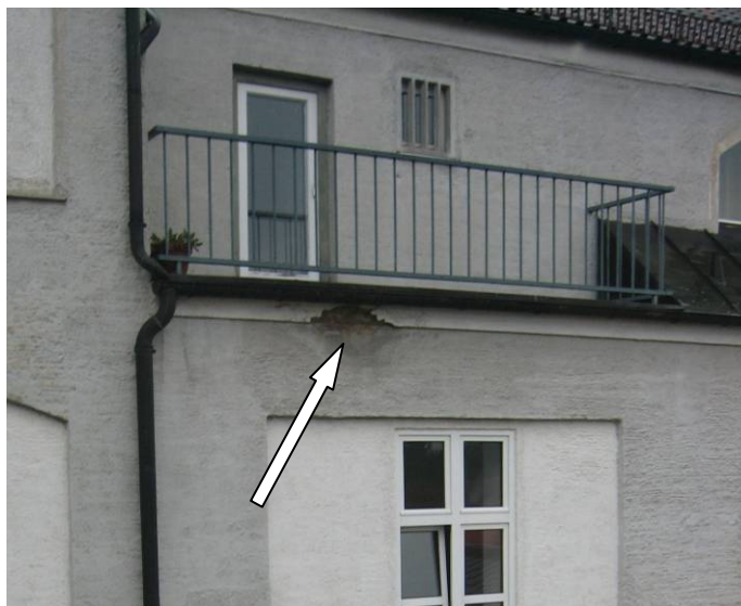
Abbildung 4-7: Neubau Ostseite: Schaden an Fassade durch Feuchtigkeit von undichter Balkonabdeckung
