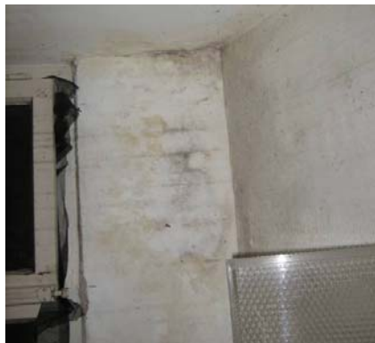
Abbildung 4-1: Altbau Keller an der Grenze zum Kriechgang Neubau: Hohe Mauerfeuchte mit Schimmelpilzbefall
