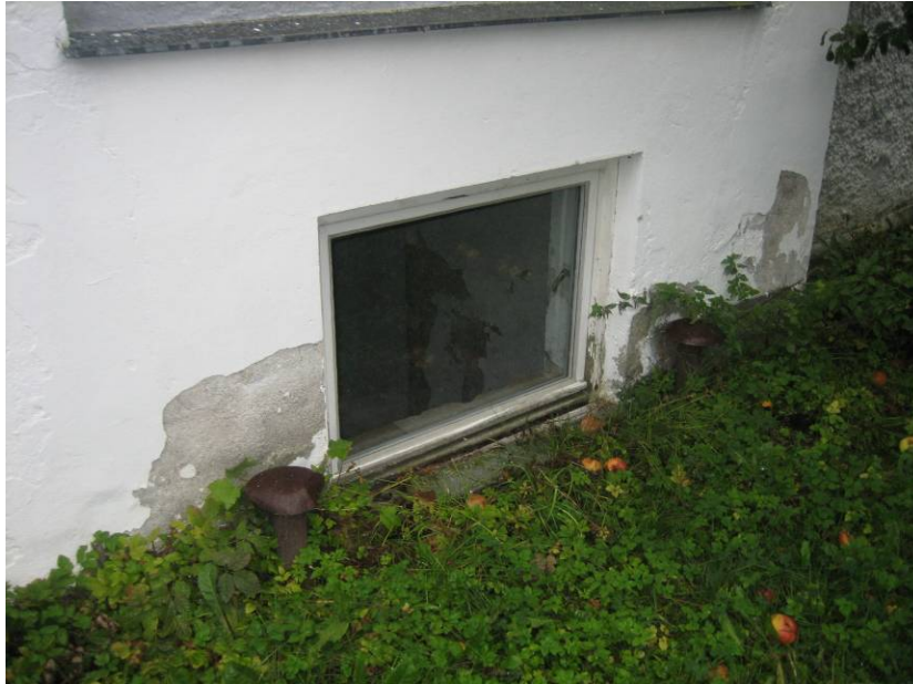
Abbildung 4-6: Ecke Altbau/Neubau: Aufsteigende Mauerfeuchte
