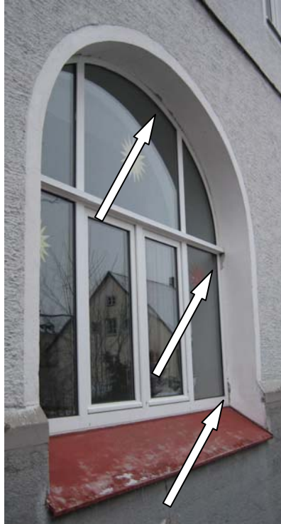
Abbildung 4-8: Saalbau Westseite: Schlechte Verankerung der Fenster führt zu Undichtigkeit
