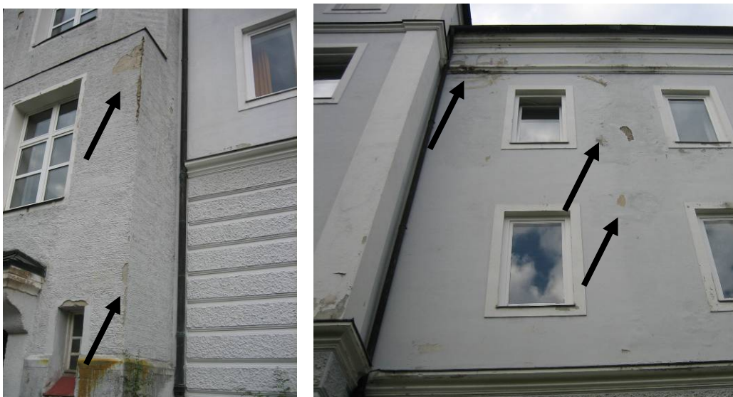
Abbildung 4-4: Feuchtigkeit im Putz durch undichte Erkerabdichtung Neubau (links) und undichte Dachrinne Altbau (rechts)
