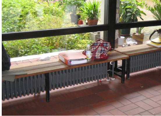
Abbildung 4-21: Pausenhalle mit Heizkörpern vor der Glasfassade
