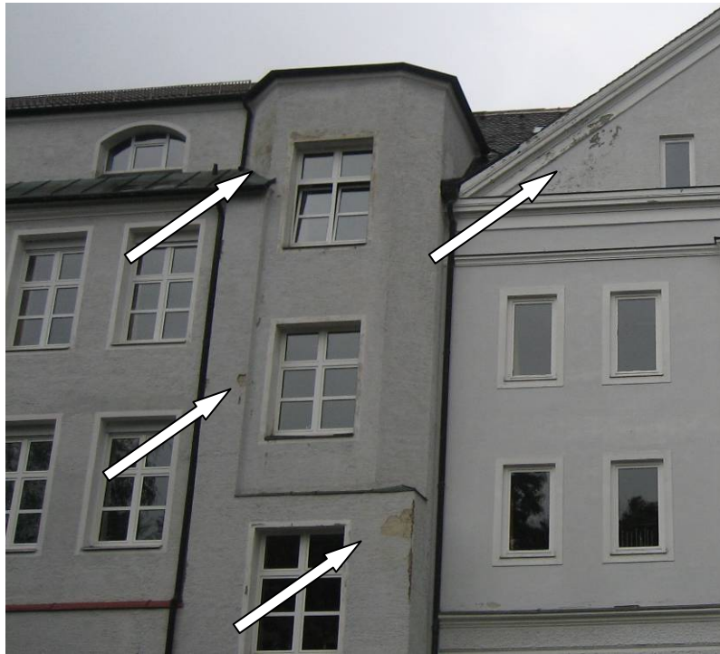
Abbildung 4-3: Schäden an der Fassade Altbau und Neubau
