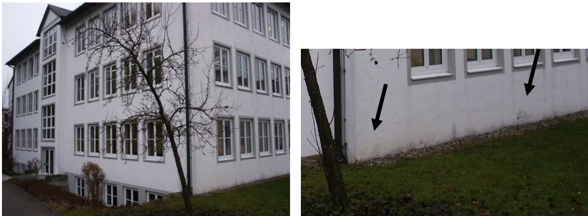
Abbildung 4-17: Gymnasium 1990: Feuchteschäden an der nordseitigen Außenwand
