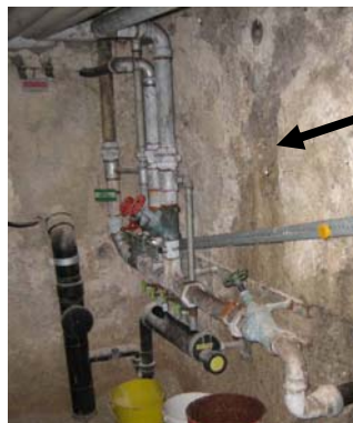
Abbildung 2-3: Undichte Wasserleitung (Frisch- oder Abwasser)
