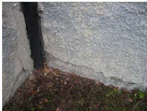
Abbildung 4-2: Übergang Altbau/Saalbau: Abbröckelnder Putz durch Anschluss der Dachrinne (undicht bzw. nicht durchgängig)
