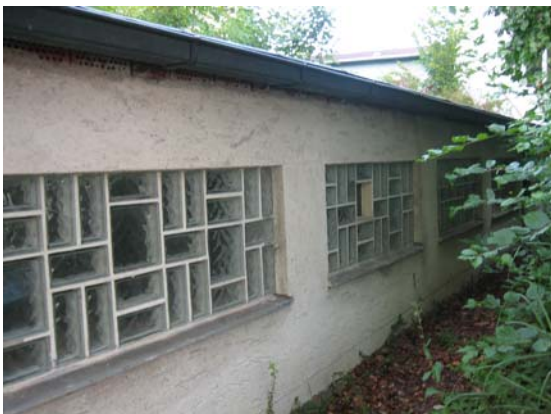
Abbildung 4-24: Ungedämmtter Gang zum Hallenbad mit Glasbausteinen
