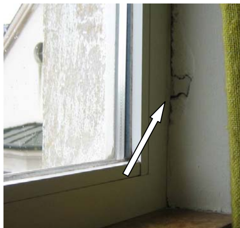
Abbildung 4-10: Schlechte Verankerung der Fenster von 1990, dadurch Auftreten von Rissen und Luftzug
