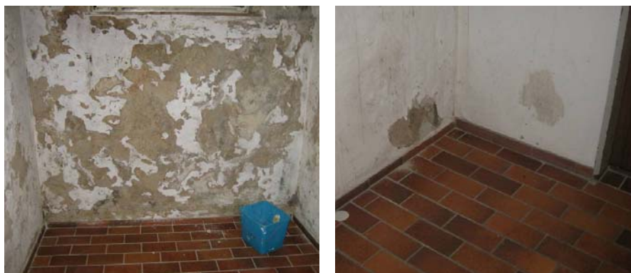
Abbildung 2-1: Feuchte Mauer im Keller des Altbaus durch von außen eindringendes Wasser (linkes Bild) und durch im Fundament aufsteigende Feuchtigkeit (rechtes Bild)
