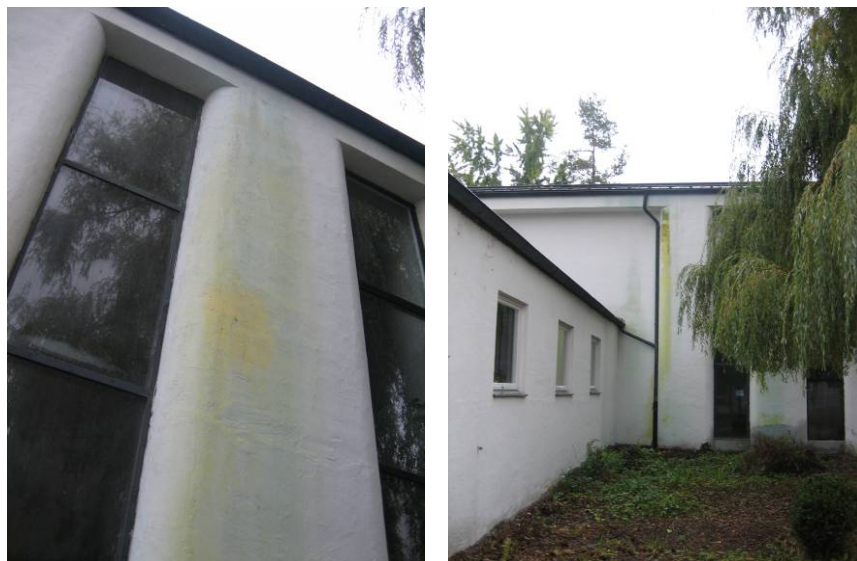
Abbildung 4-25: Verschmutzte Fassade durch überlaufende/verstopfte Dachrinne
